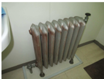
旧式の暖房設備
