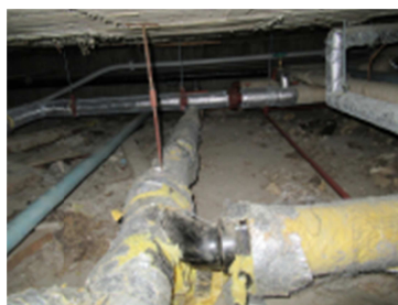
設備配管劣化状況
