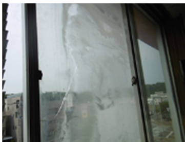
割れている窓
