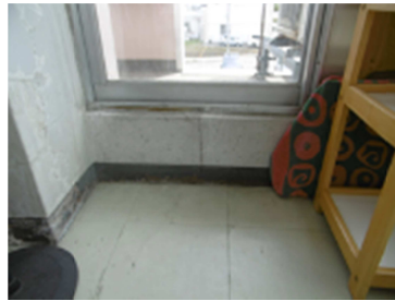
窓廻りの老朽化と 窓下のひび割れ
